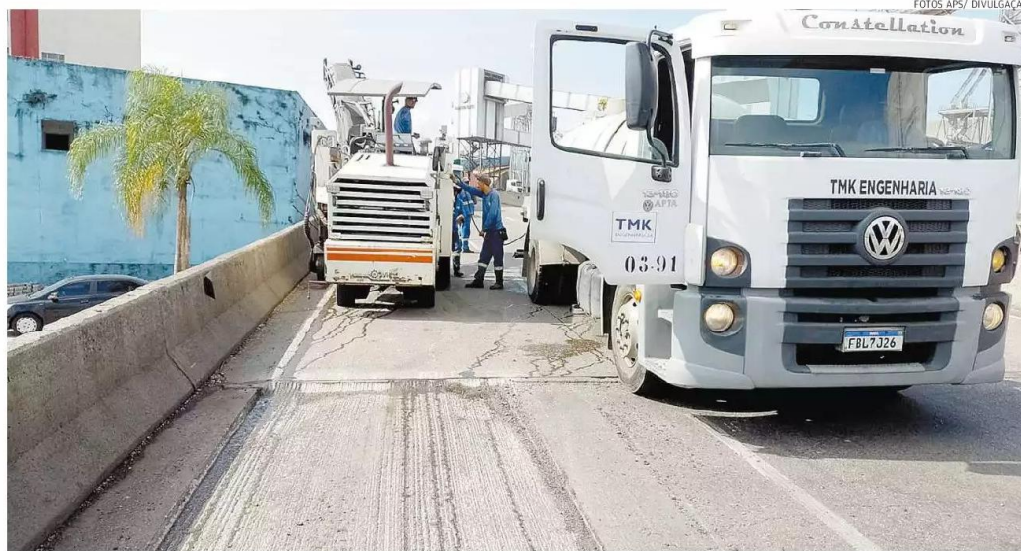
Fotos enviadas pela Autoridade Portuária mostram serviços de raspagem na avenida, sentido Ponta da Praia, para receber novo asfalto
