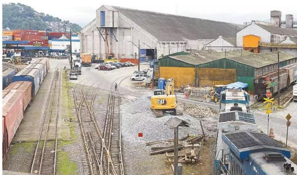
Serviço realizado na Margem Direita pela AG-Fips é considerado fundamental para o Porto de Santos ganhar eficiência no modal ferroviário
