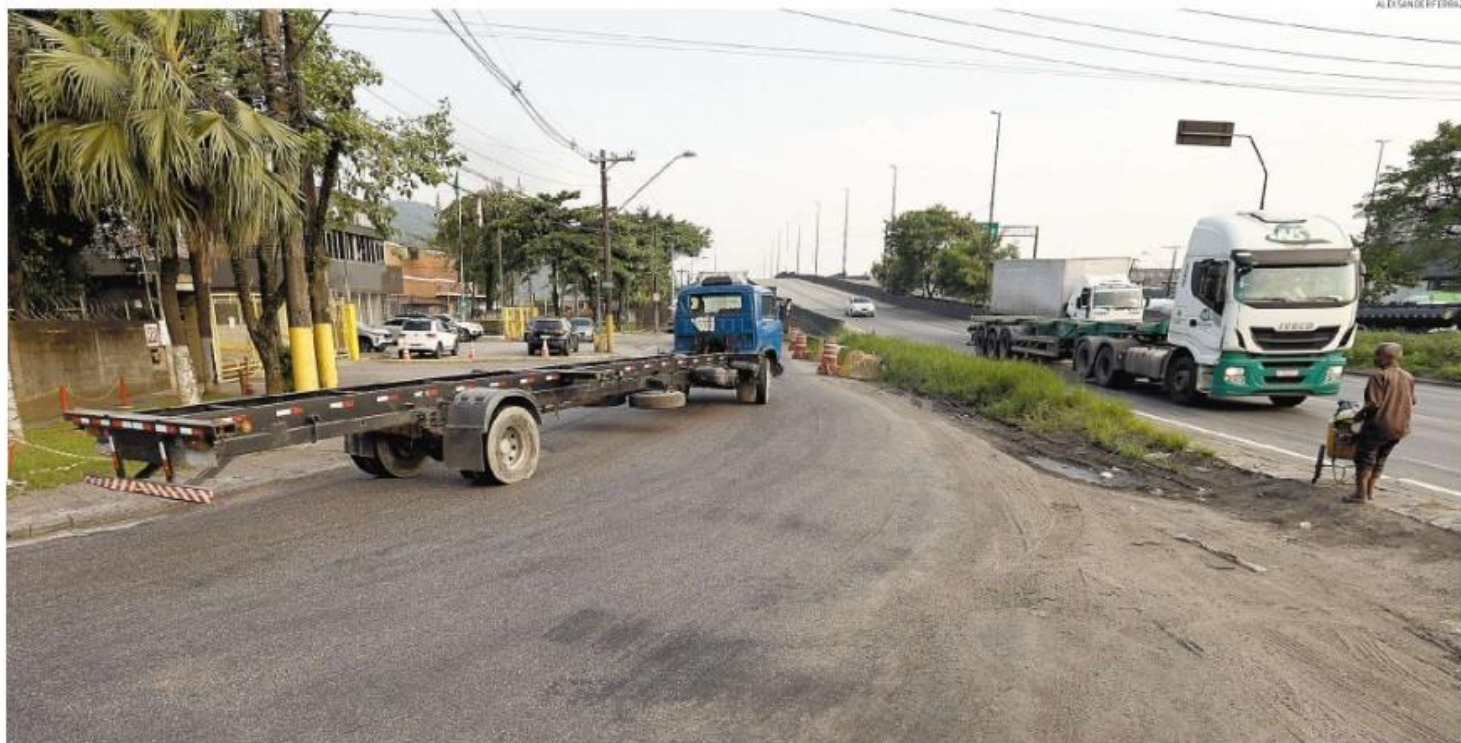
Viaduto da Alemoa conta com acesso precário e o trânsito fica travado quando aumenta o fluxo de caminhões; existe área disponível no entorno, hoje repleta de mato e lixo, para que ocorra um alargamento da pista
