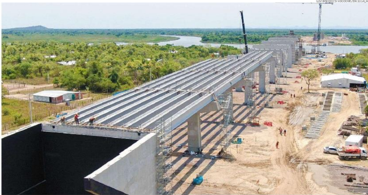
Construção da ponte sobre o Rio Paraguai, na fronteira entre Porto Murtinho (Brasil) e Carmelo Peralta; a estrutura terá 1.294 metros de comprimento e 29 metros de altura
