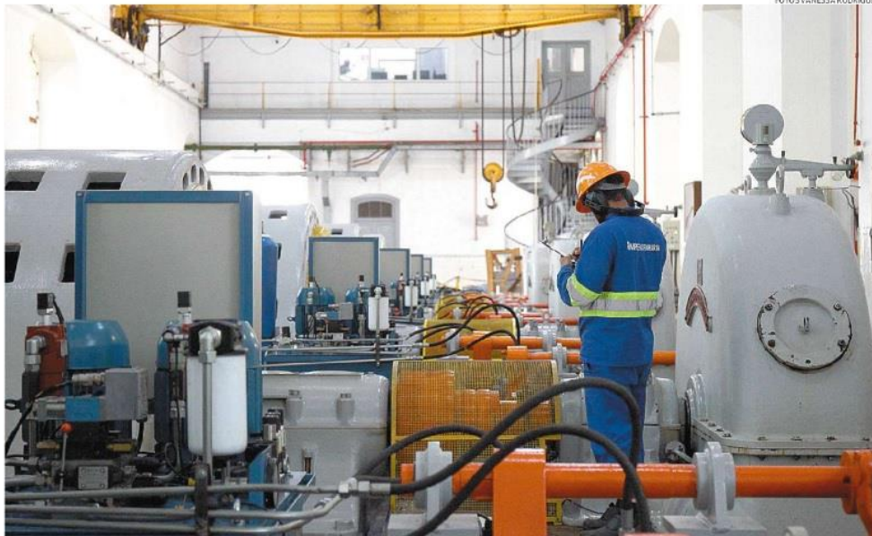
Com 113 anos, a usina hidrelétrica localizada em Bertioiga abastece a sede administrativa do Porto de Santos e dez terminais arrendatários
