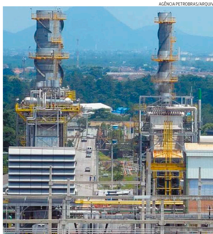
Térmica da refinaria tem capacidade para cidade de 800 mil habitantes
