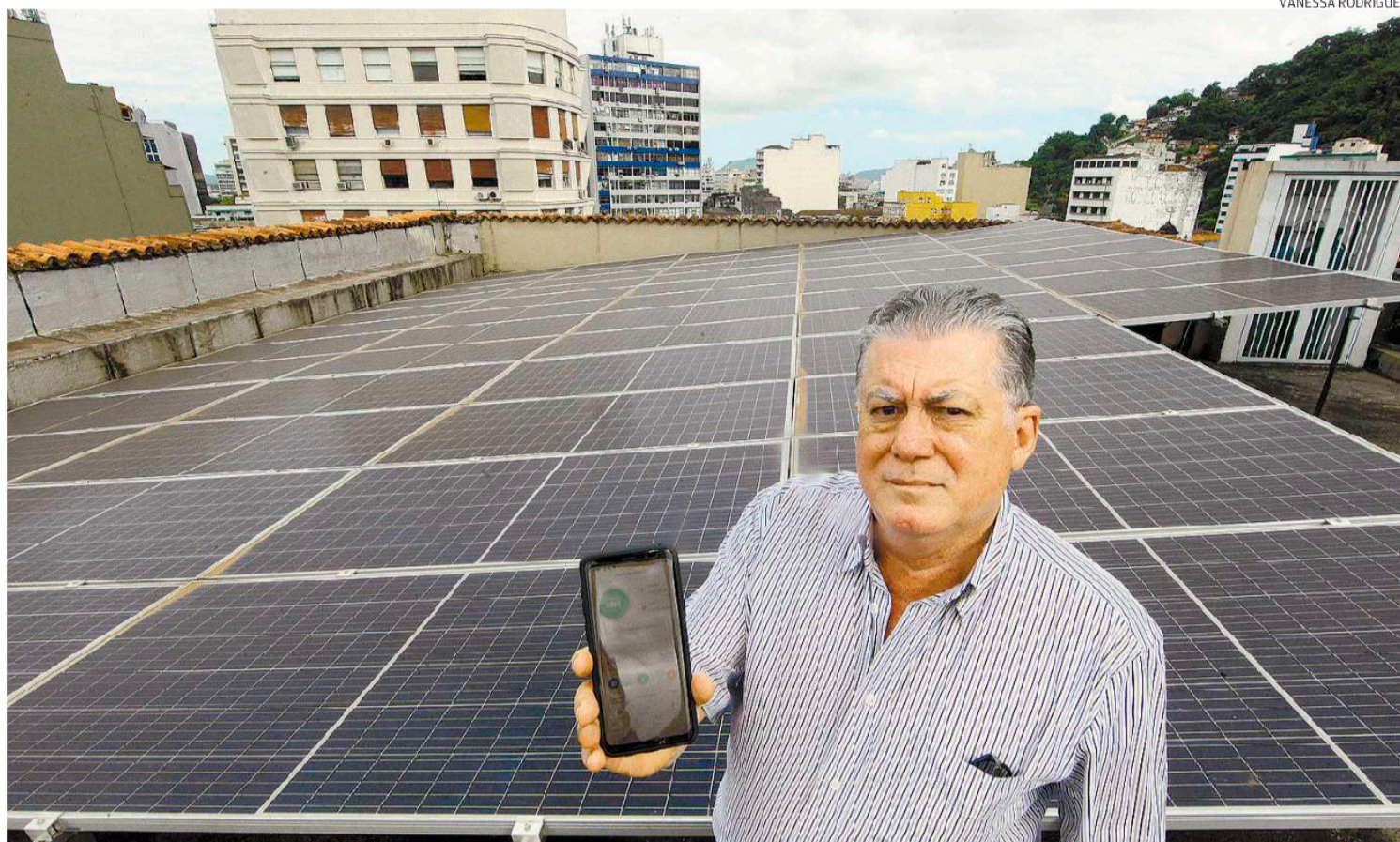
Noslen Botelho, síndico do Rubiácea desde 2007, já tinha planos de investir em energias renováveis, mas só agora os custos ficaram acessíveis
