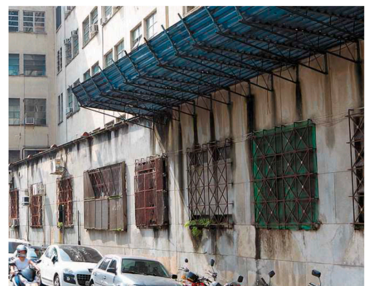
Em 90 dias, devem ocorrer obras que minimizem a queda de materiais
