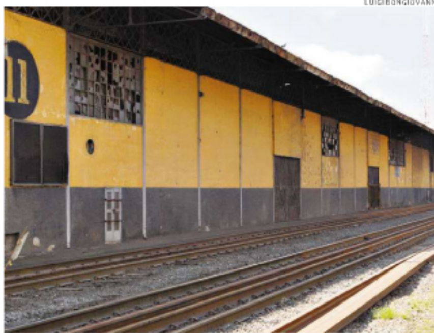
Armazém onde estão os cilindros com gases tóxicos está deteriorado
