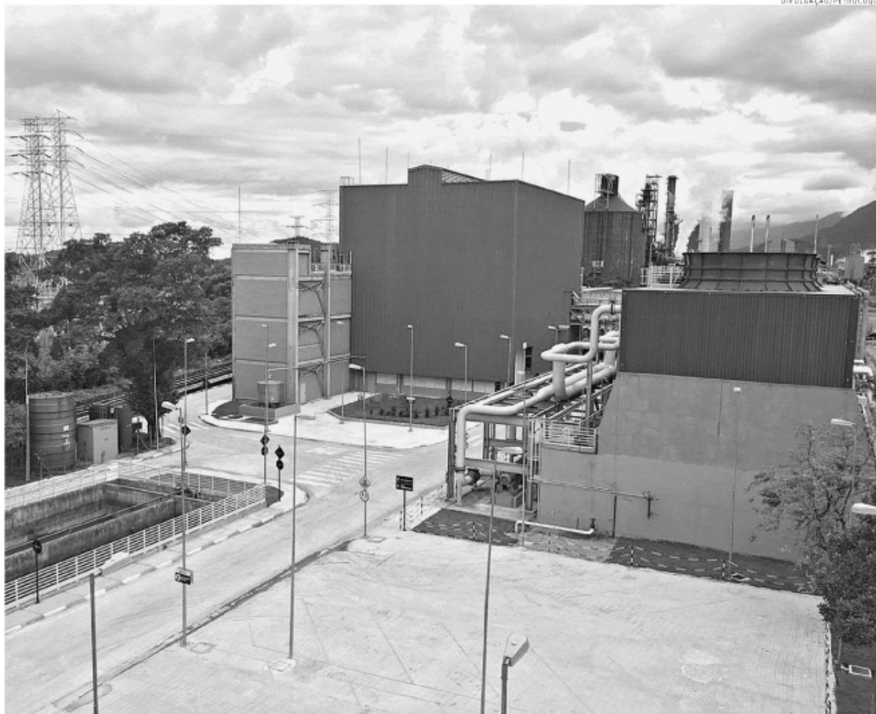
O novo empreendimento entra em operação na primeira quinzena de abril, com capacidade para gerar aproximadamente 18 MWh de energia
