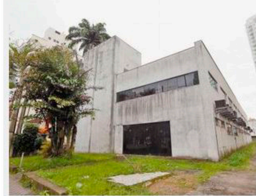
Prédio, com 1,1 mil metros quadrados, ficou abandonado por oito anos, devido a problemas na construção
