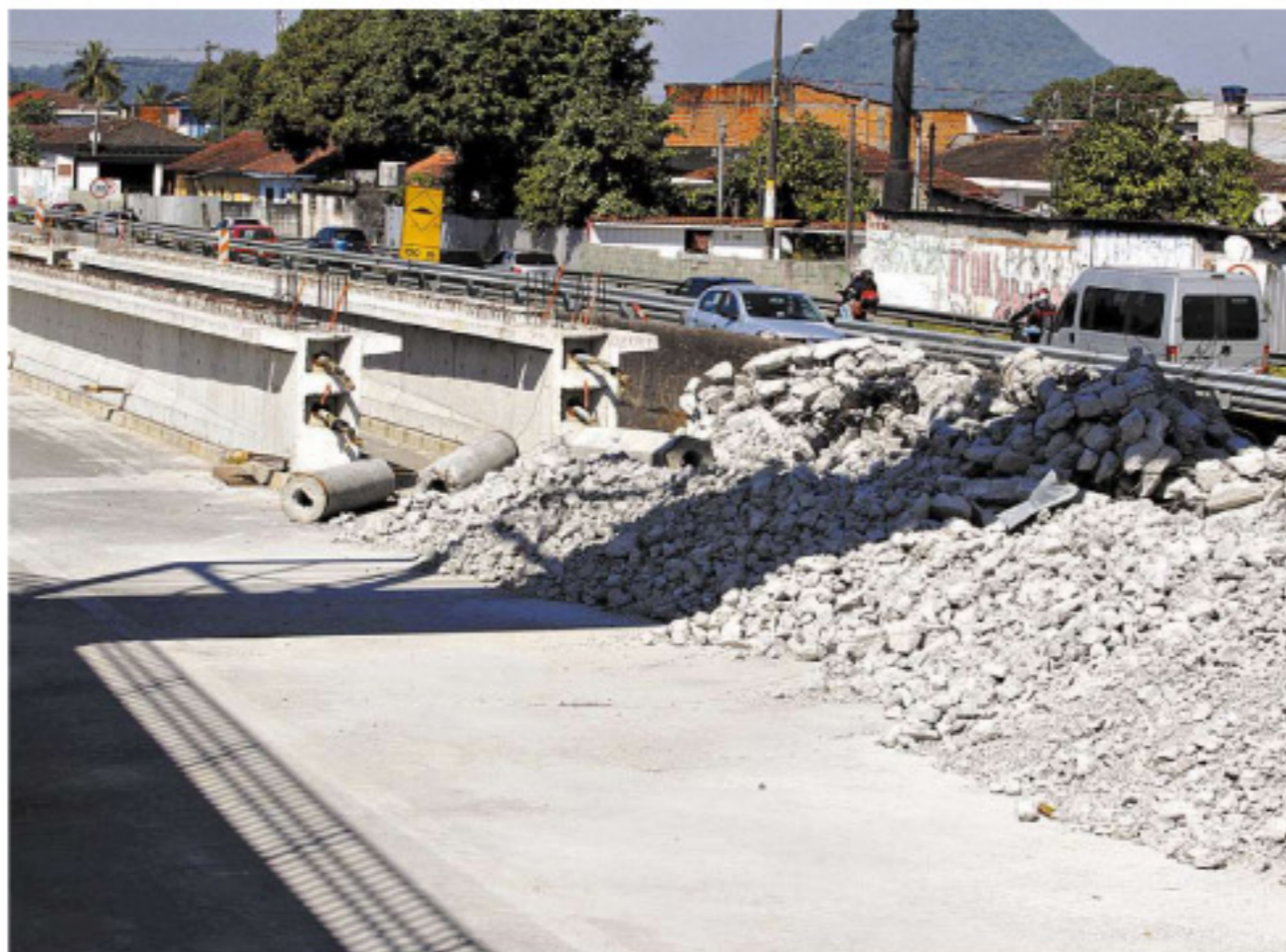
Ao longo das obras, o cenário é desolador com restos de ferragens e vigas e pedras acumuladas
