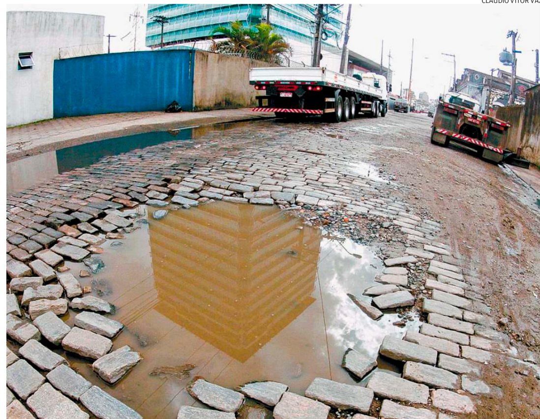
Ruas esburacadas, calçadas estreitas e imóveis deteriorados ainda afetam arredores da torre da Petrobras
