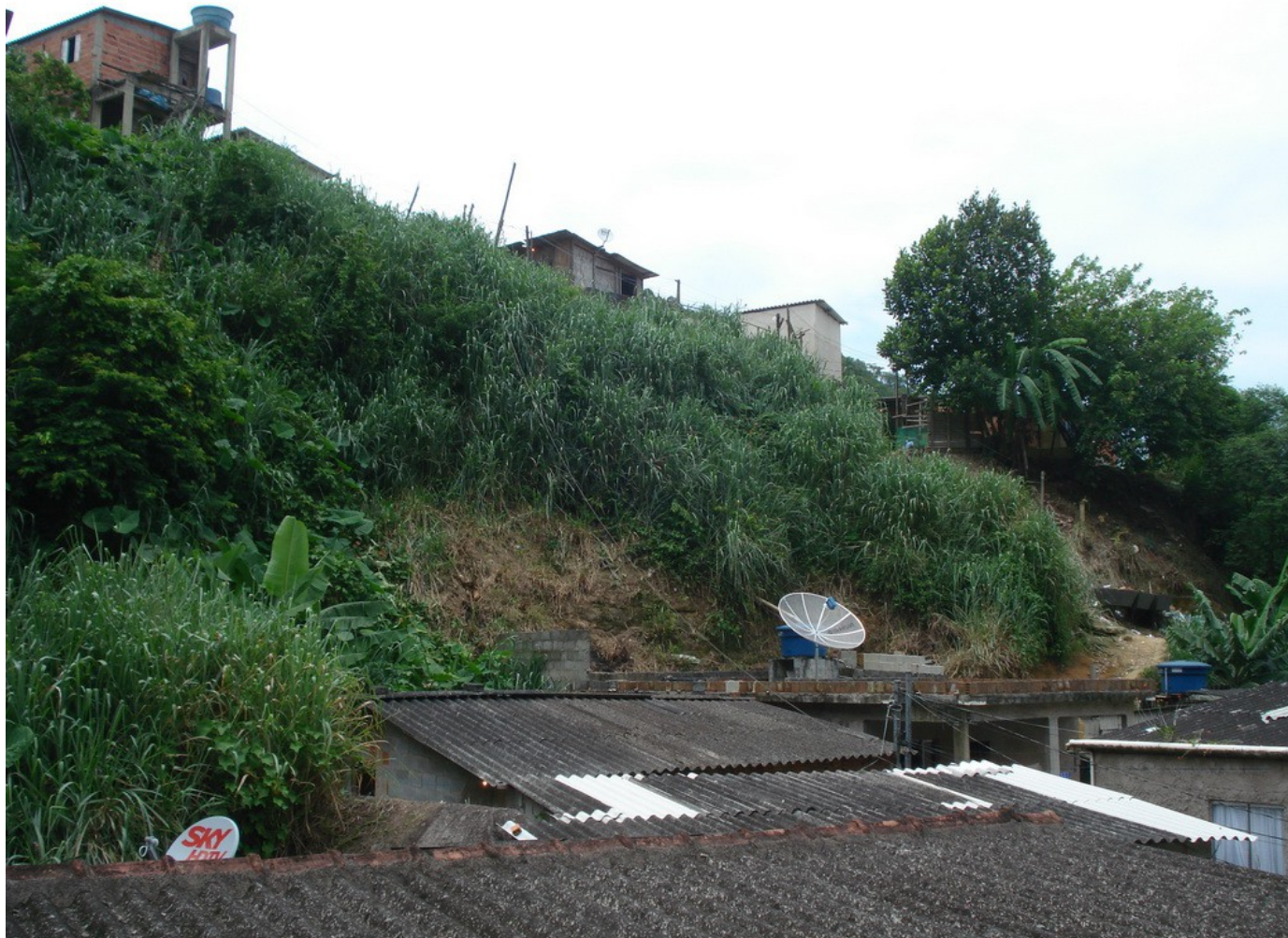
Foto FC-ST-20-01.02: Notar a presença de cicatrizes de escorregamento no talude localizado nos fundos das moradias (Caneleira).
